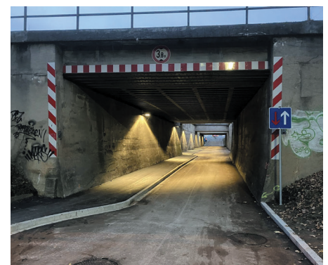
Die verbesserte Ausleuchtung sorgt für zusätzliche Sicherheit.
