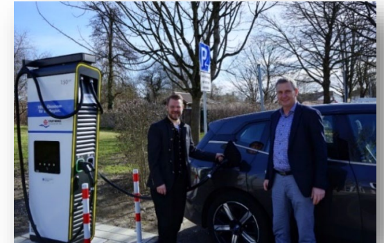
Inbetriebnahme des Ladeparks am Stadtwall im Frühjahr 2024
