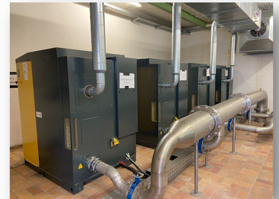
Neue Gebläseanlage im Klärwerk
